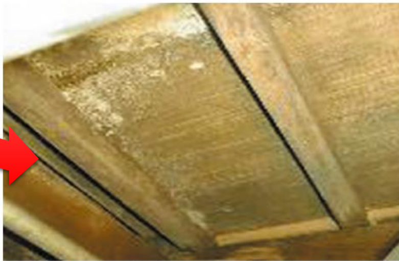
白いカビが発生すると、木材は腐ります。
