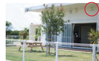
軒下に取付けられた空調換気ファン
